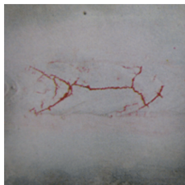
浸透探傷検査により 検出されたきずの例
